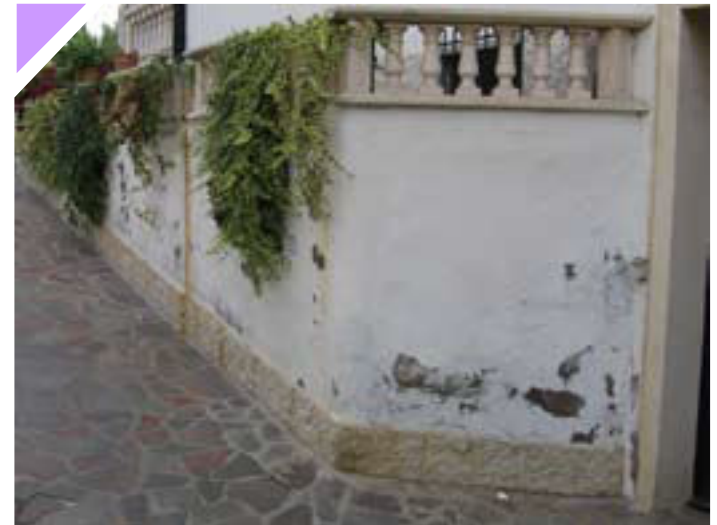
Impermeabilizzazioni negative: infiltrazioni in strutture contro terra, soggette a pressioni provenienti dal terreno retrostante.
