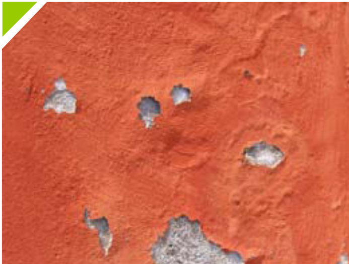
Umidità di risalita capillare: sviluppo di efflorescenze con distacchi di tinteggiature e rasanti.
